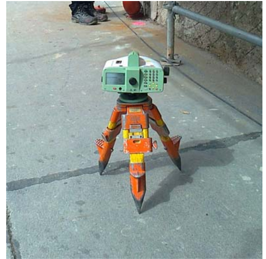
Einsatz eines Mini-Stativs für sehr niedrige Visuren (z.B. bei nach oben abgedeckten Setzungspunkten)
