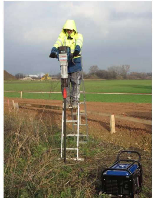
Dauerhafte Vermarkung eines Festpunktes mit einem 1,5m langen Eisenrohr im Bereich der Pottendorfer Linie in NÖ
